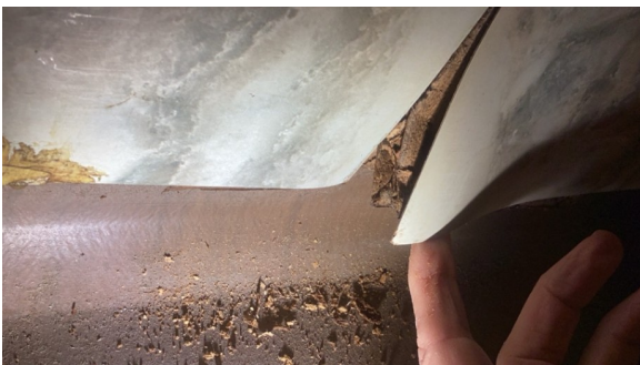
Råteskade på våtromsplater i våtsone.
