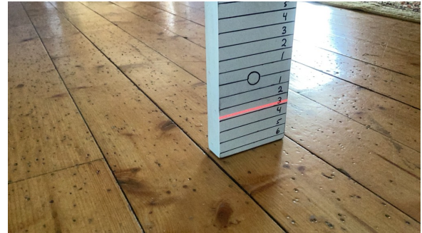
1 etg. verflateavvik, stue.
