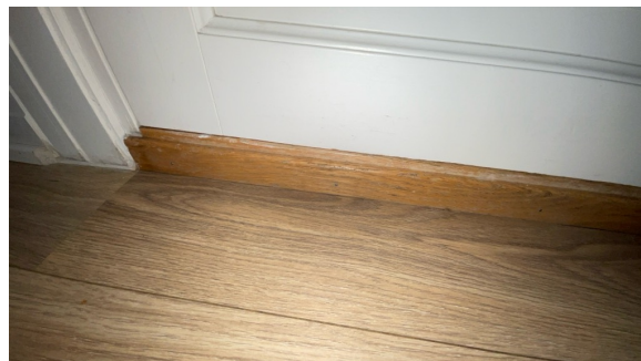
Ingen luftespalte under dørbildet.
