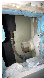
Plastrør innenfor inspeksjonsluke i vegg på badetrommet.
