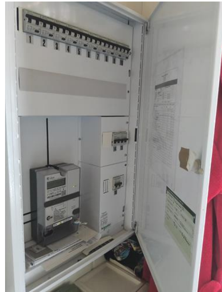
Elektrisk anlegg - [Sikringsskap ]
