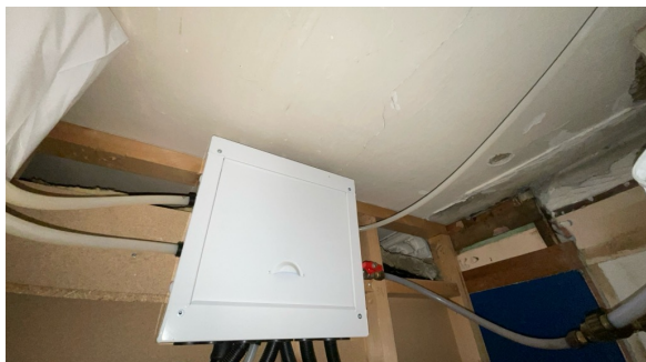
Fordelerskap over inspeksjonsluke i himling på baderommet.
