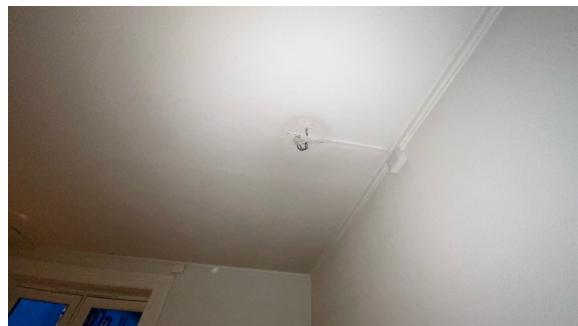
Ledning i taket på kjøkken må blendes/tilkobles på en fagmessig måte.
