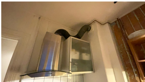
Avtrekksvifte på kjøkken.
