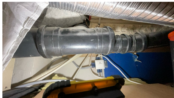
Både plastrør og kobberør.
