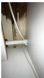
Hvitt avløpsrør på kjøkken må festes bedre.
