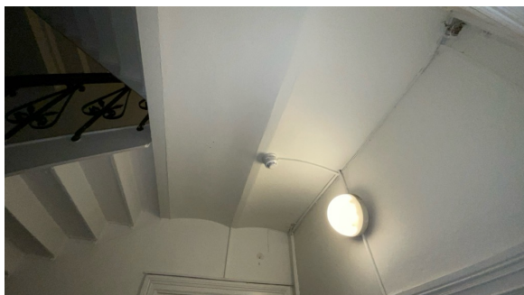
Felles brannvarslingsanlegg i fellesgangen.
