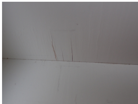
Det er sprekker i vinduskarm.
