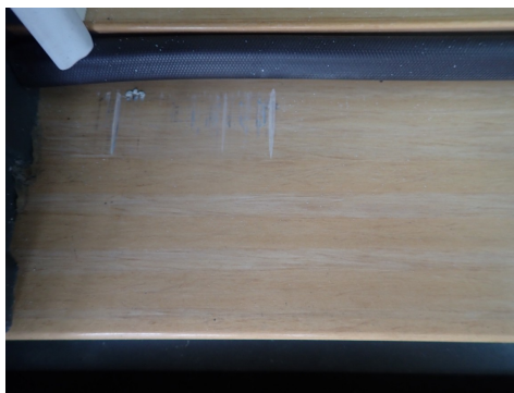
Balkongdør subber mot terskel.
