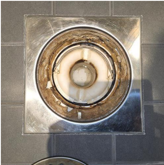
Avløpsrør (ink. sluk) - [Sluk bad]
