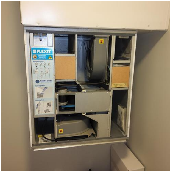
Innvendig - [Ventilasjonsanlegg plassert i bod]
