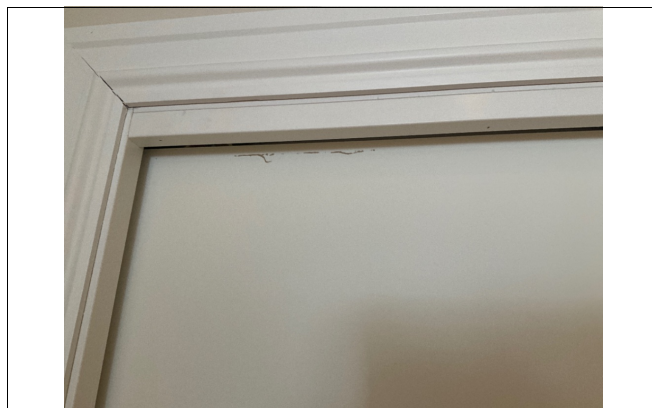
Skade på skyvedør.
