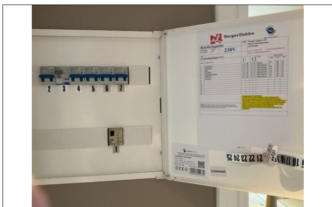
Kontroll av sikringsskap.
