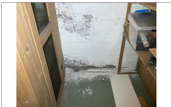
Salt-fuktutslag i kjellerbod.
