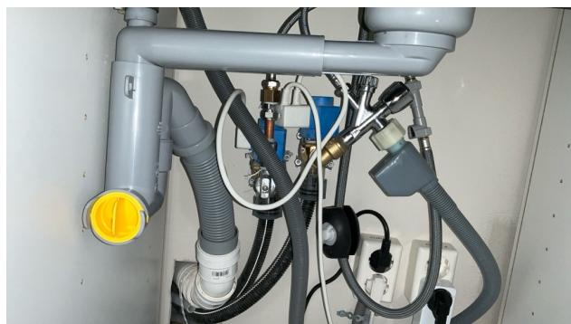
Avløp vask kjøkken
