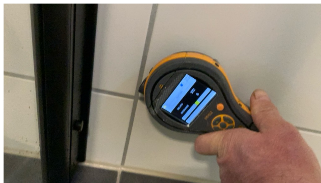
Normale fuktvariasjoner i området med sprekk
