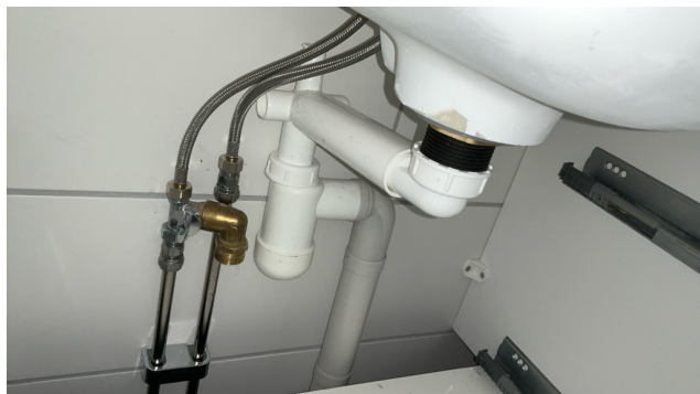
Avløp servant bad
