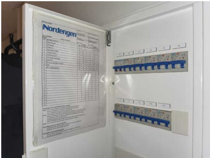
Elektrisk anlegg - [Sikringsskap]
