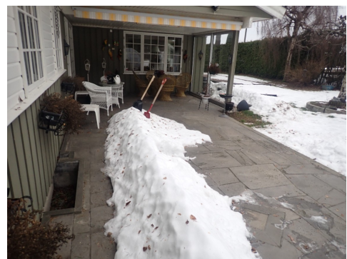
Terrasse delvis snødekt på befaringsdagen
