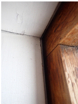
Flere vinduer tetter dårlig mellom karm og ramme.
