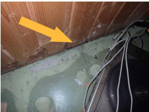
Det er påvist fuktskjolder på trepanel mot bod
