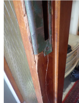
Karm på inngangsdør er skadet.
