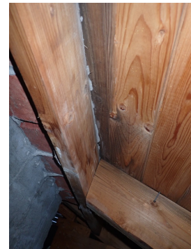
Skjolder av fukt i undertak ved pipe
