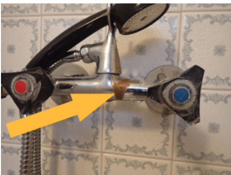
Det er påvist lekkasje ved venstre blandeblender i dusj.
