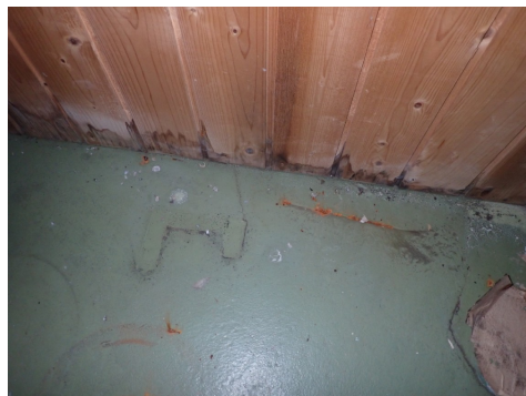
Det er synlige fuktskader ved svill i vegg mellom badet og stor bod.
