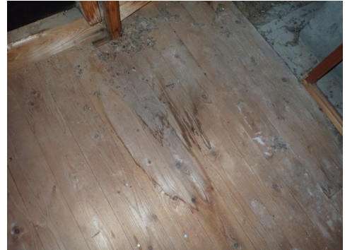
Skjolder på gulv loft
