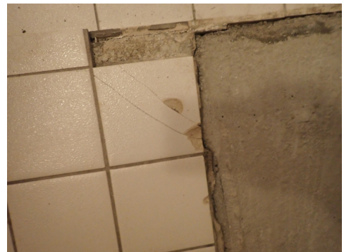
Fliser på gulv har sprukket
