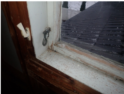
Værslitt i vinduskarm på loft.
