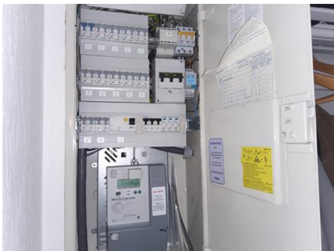
Beskrivelse - [Sikringsskap med kursfortegnelse. ]
