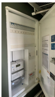
Sikringsskap er plassert i skap i entré.
