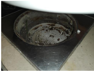
Tettesjiktets tilslutning til sluk - Sluk Baderom 4.etasje.
