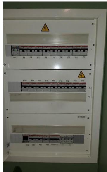
Elektrisk anlegg - [Sikringskap ]
