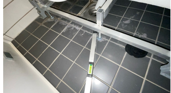
Fallforhold målt i retning sluk under badekar.
