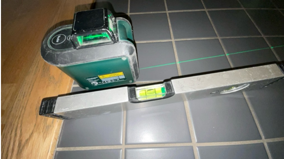
Svakt motfall på baderomsgulvet ved dørterskel i retning sluk.
