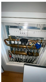
Fordelerskap for vannbåren gulvvarme.
