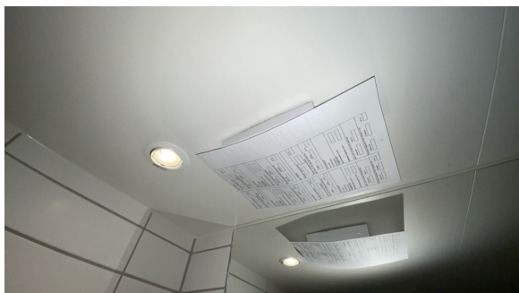
Test med løst ark viste tilfredsstillende avtrekk.
