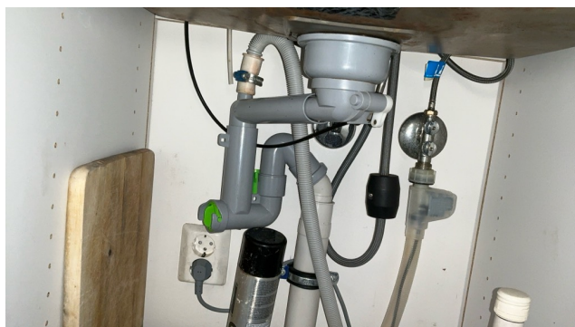
Avløp vask kjøkken
