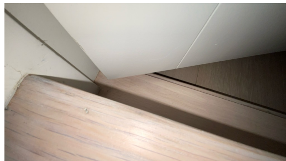
Luftespalte under dørbildet.
