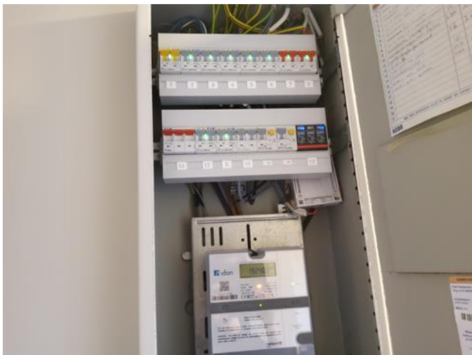
Elektrisk anlegg - [Sikringsskap]
