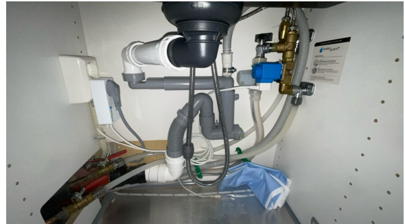
Vannrør på kjøkken. Blå magnetventil (lekkasjestopper).
