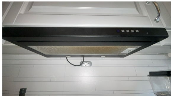
Kjøkkenventilator med kullfilter.
