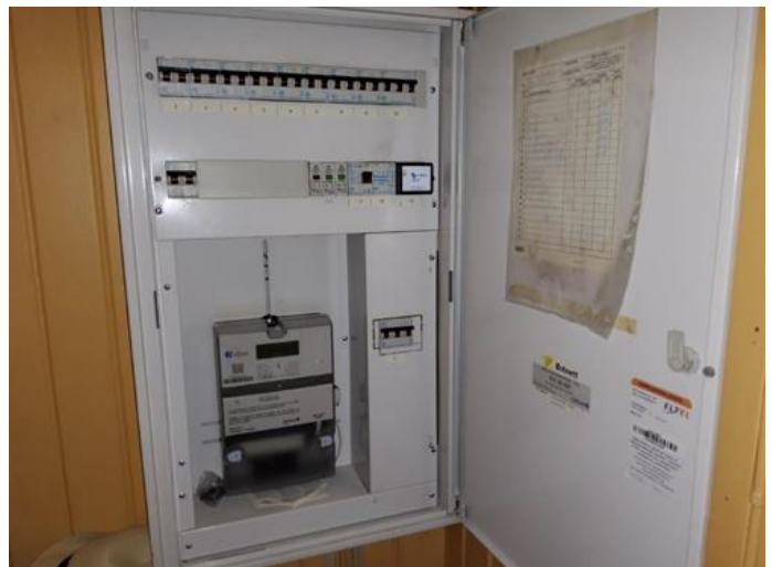
Elektrisk anlegg - [Sikringsskap. ]
