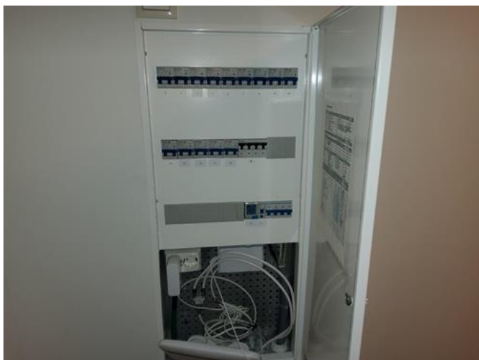
Elektrisk anlegg - [Sikringsskap. ]
