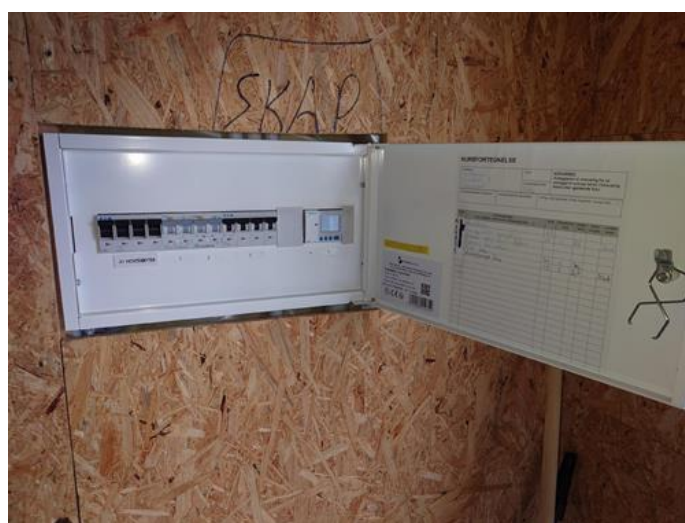
Elektrisk anlegg - [Sikringsskap garasje.]
