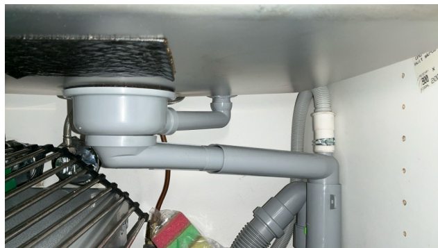
Avløp vask kjøkken
