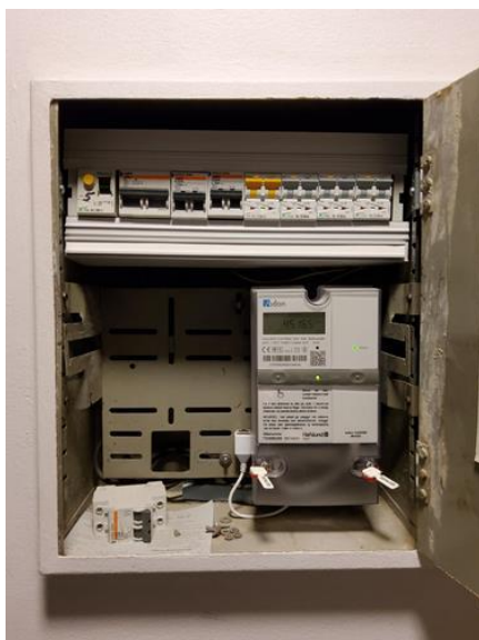
Elektrisk anlegg - [Sikringsskap]
