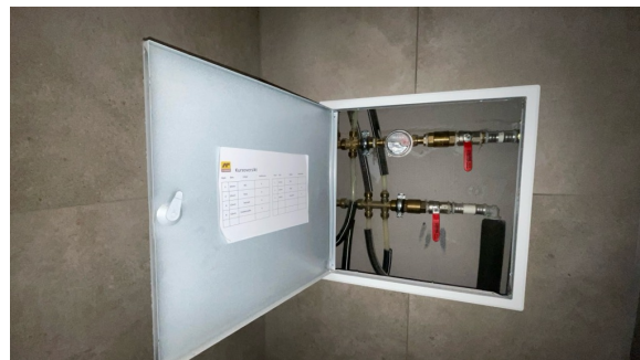
Fordelerskap på bad.
