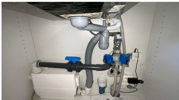
Rørpropplegg på kjøkken.
