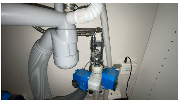
Lekkasjestopper (blå magnetventil).
