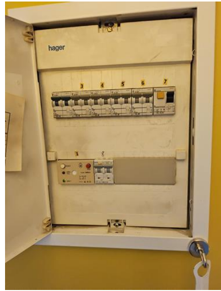
Elektrisk anlegg - [Sikringskap ]
