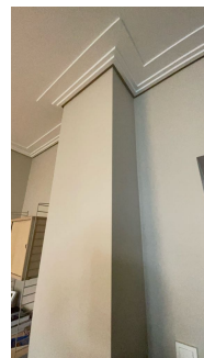
Pipeløp er ikke synlig pga. type overflate.
