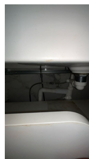
Avløpsrør under servanten har svakt motfall (feil fall).
