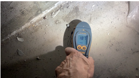
Kjellergulv. Ved enkle fuktsøk ble det ikke registrert unormale verdier.
