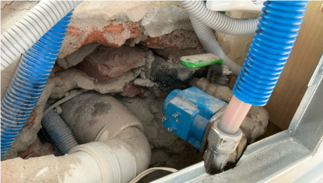
Stoppekran bak luke i vegg soverom 3. etasje.
