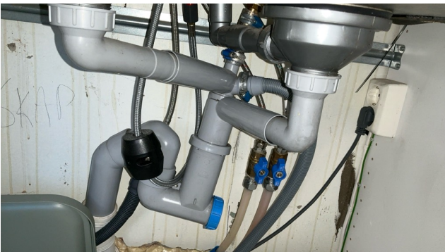
Avløp vask kjøkken
