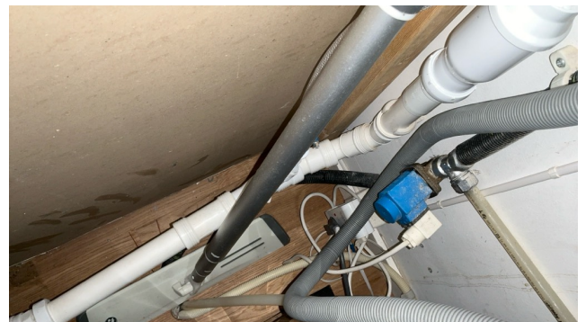
Automatisk lekkasjesikring montert i skap med bereder og vaskemaskin.
