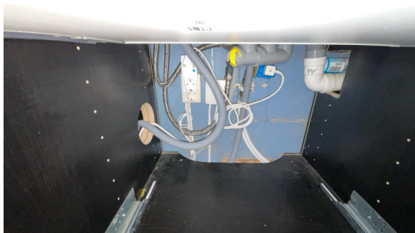
Røropplegg på kjøkken. Lekkasjestopper.
