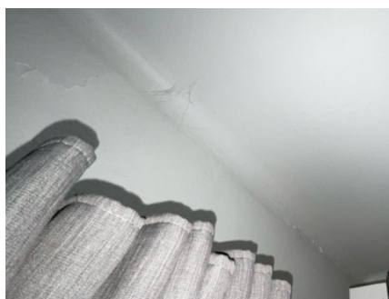
Noe avskalling i himling mot yttervegg på hovedsoverom.
