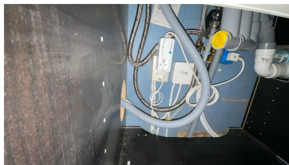
Lekkasjestopper. El-tilkobling til bereder.
