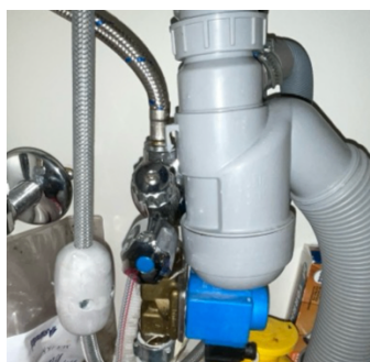
Rørøpplagg på kjøkken. Blå lekkasjestopper (magnetventil).
