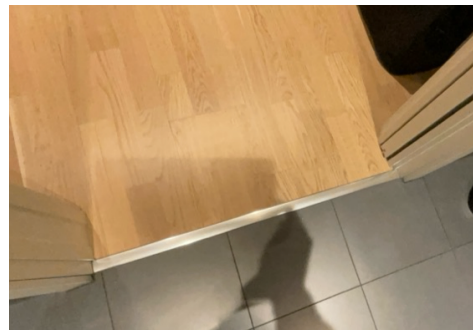
Luftespalte under dørbladet.
