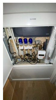
Fordelerskap for vannbåren gulvvarme.
