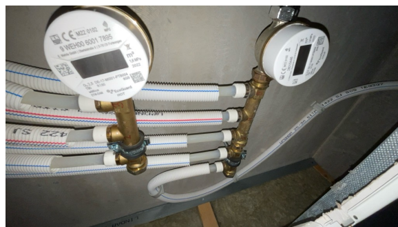
Samlestokk med vannrør på baderommet.
