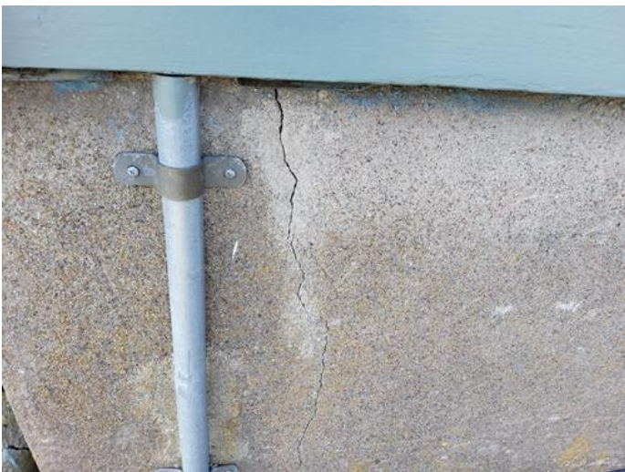
Beskrivelse - [Eksempel på sprekkdannelser på grunnmur]
