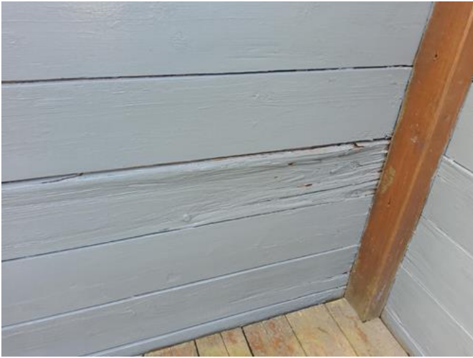
Beskrivelse - [Eksempel på råteskader balkongrekkverk]
