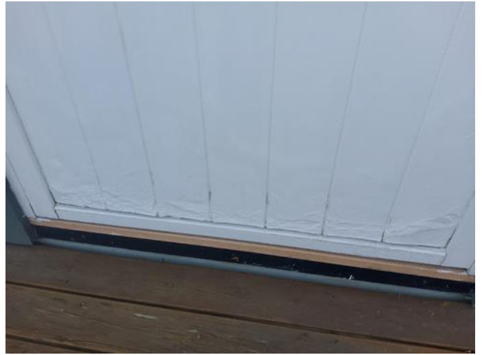
Dører og vinduer - [Svelleskader på balkongdør]
