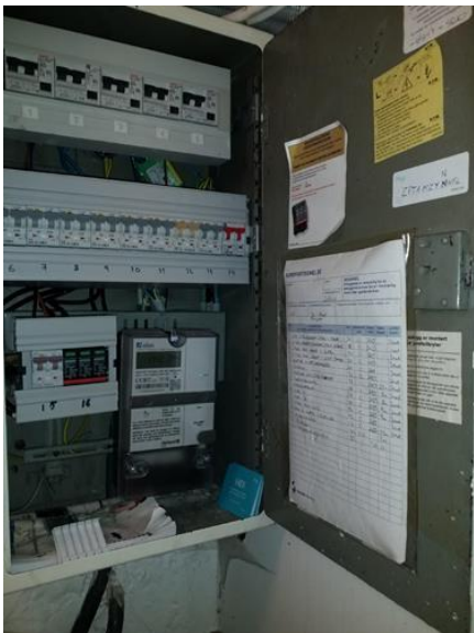
Elektrisk anlegg - [Sikringskap ]
