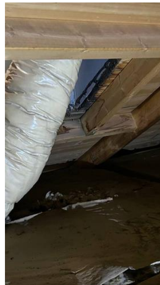
Overflater vegger/undertak - [Fuktmerker ved rørgjennomføring ]
