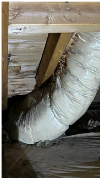
Overflater vegger/undertak - [Fuktmerker ved rørgjennomføring ]
