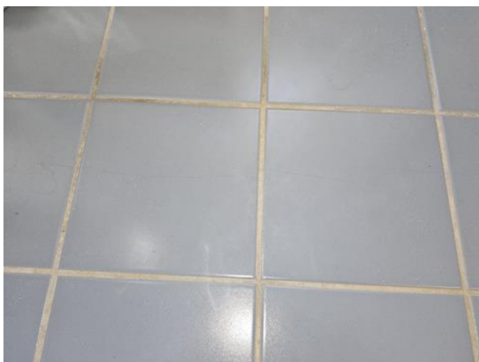
Overflater gulv - [Sprekk i gulvfliser]
