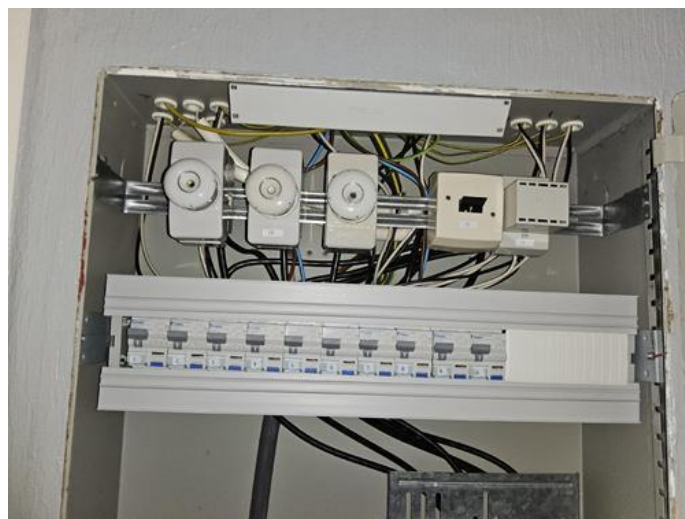
Elektrisk anlegg - [Sikringsskap]
