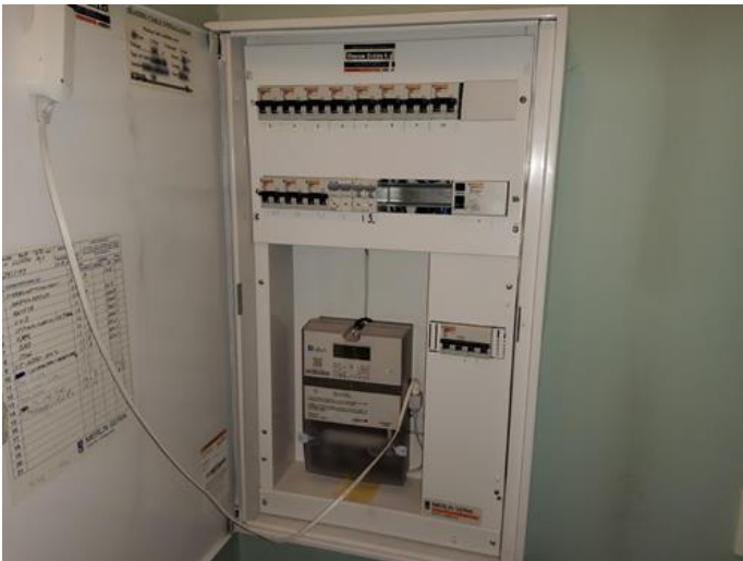
Elektrisk anlegg - [Sikringskap. ]
