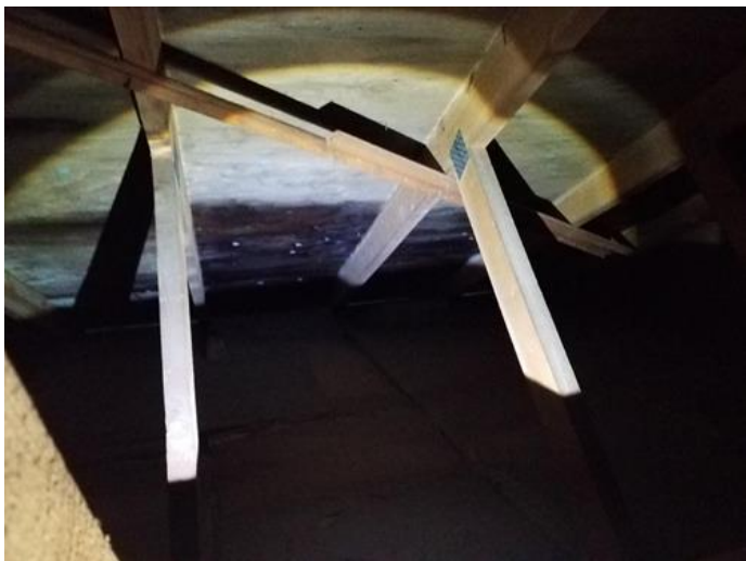
Overflater vegger/undertak - [Fukt i undertak på loft.]
