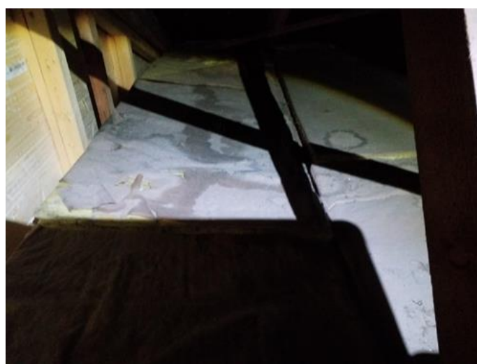
Overflater vegger/undertak - [Fuktmerker på isolasjon på loft.]
