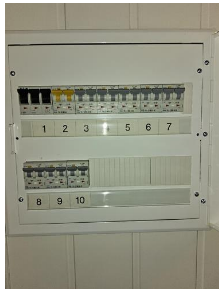
Elektrisk anlegg - [Sikringskap ]
