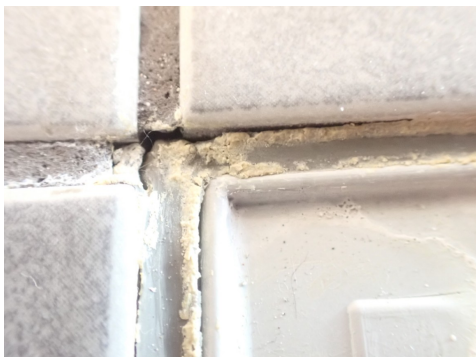
Riss og åpne fuger rundt sluk
