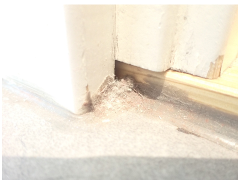
Det er åpent inn ved avslutning dør/omramming og dørterskel venstre side
