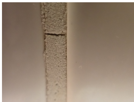
Riss i flere fuger på vegg i dusj.
