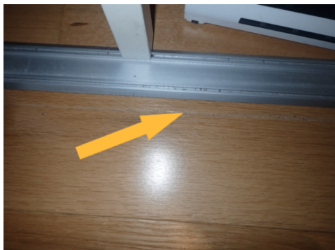
Skadet parkett i gang ved garderobeskap
