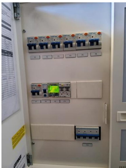
Elektrisk anlegg - [Sikringsskap]
