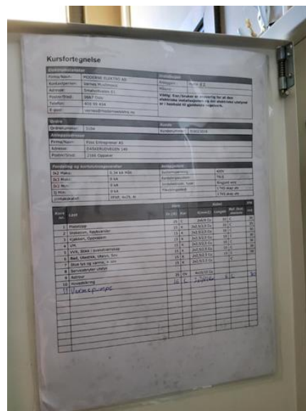
Elektrisk anlegg - [Kursfortegnelse]
