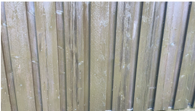
Det er værslitt/oppsprukket trevirke/trepaneler.
