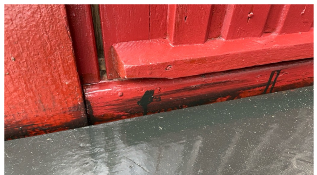
Liten skade på ytterdør
