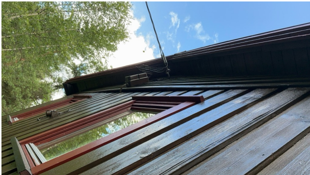
Liggende kledning i toppen buler ut på midten
