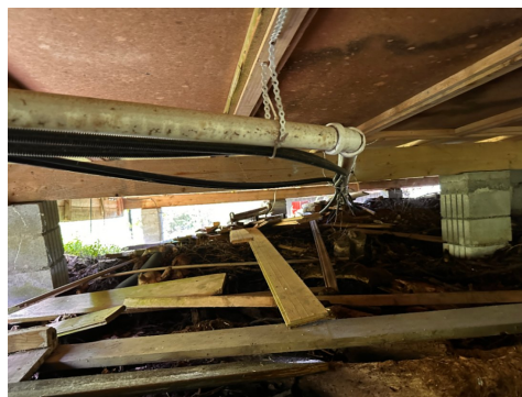
Vann og avløp synlig under hytten
