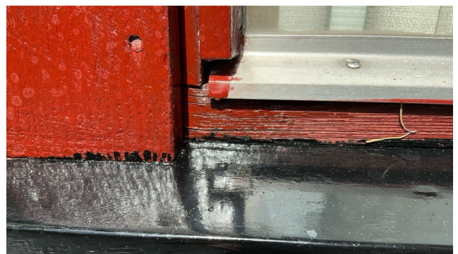
Det er påvist lite og ingen klaring mellom beslag og trevirke, noe som kan føre til råteskader. Karmene i flere vindu er slitte og det er sprekker i trevirket.
