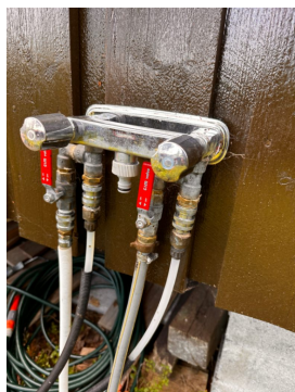
Utvendig krane med tilkobling til annekset sin utedusj
