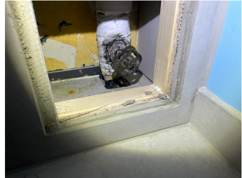
Stoppekran er påvist i WC rom.
