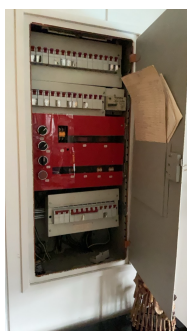
Sikringsskap plassert i kjellerstue.
