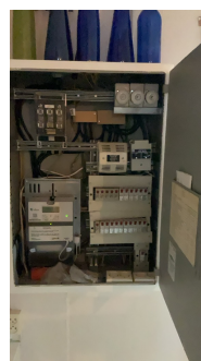
Sikringsskap er plassert i trapp mellom 1.etasje og loftsetasje.
