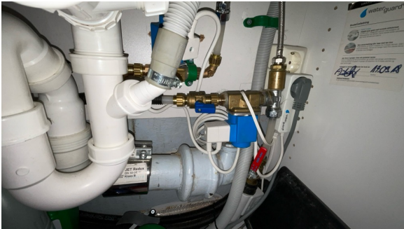
Rørplegg på kjøkken. Blå magnetventil (lekkasjestopper).
