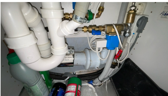
Gammelt avløpsrør i støpejern på kjøkken.
