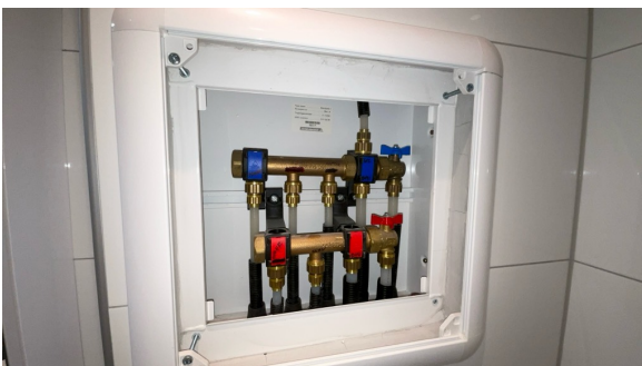
Fordelerskap på baderommet.
