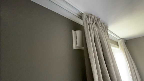
Lufteluke i yttervegg.
