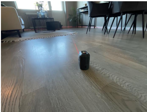
Nivellering stue/kjøkken, avvik ca. 10-20 mm
