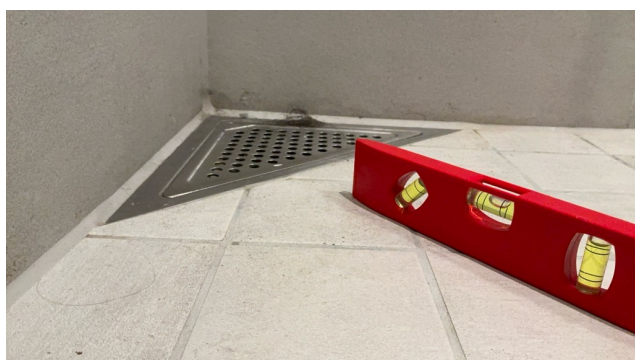
Fall mot sluk i dusjsonen
