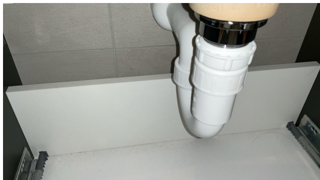
Avløp servant bad
