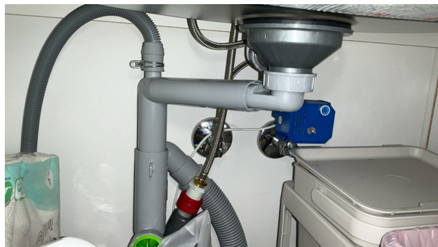
Avløp vask kjøkken
