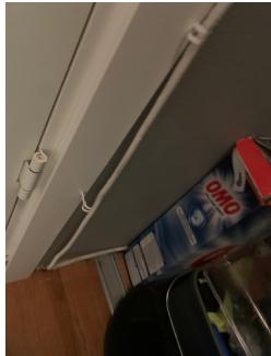
Ledning må klamres fast tilstrekkelig
