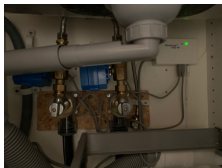
Rørapplegget i kjøkkenet
