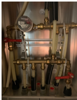
Rørskap plassert i bad. Stoppekraner fungerer som tiltenkt
