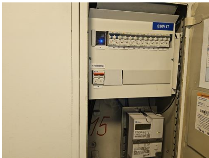
Elektrisk anlegg - [Sikringsskap. ]
