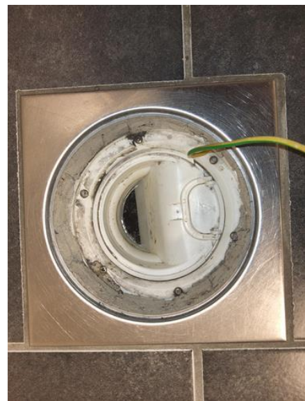
Kommentar - [Sluk vaskerom ]
