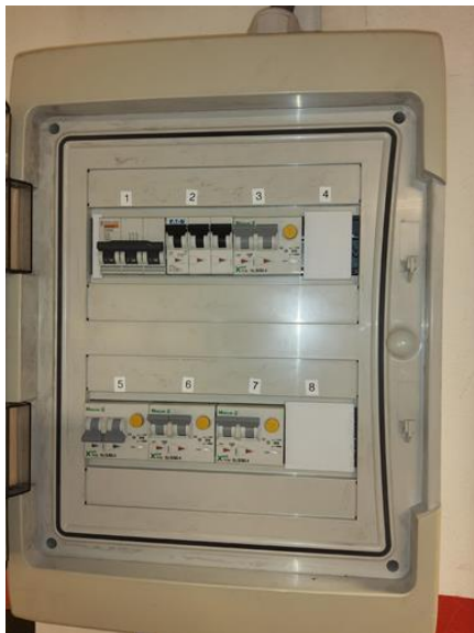
Beskrivelse - [Sikringsskap garasje]
