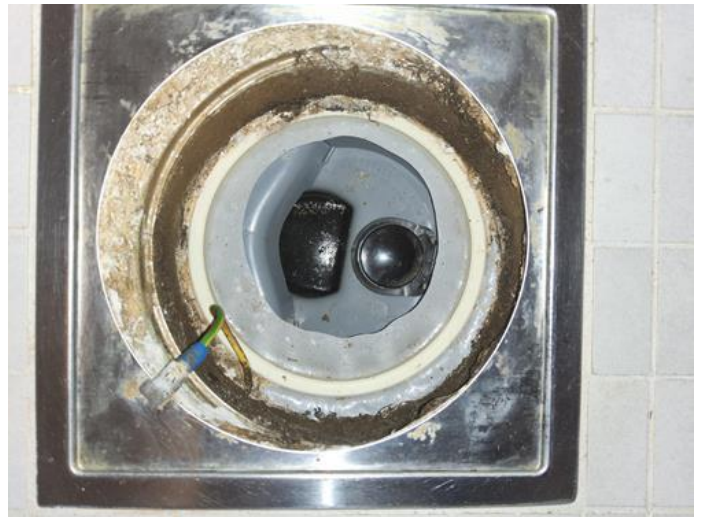
Kommentar - [Sluk bad 1.etasje ]
