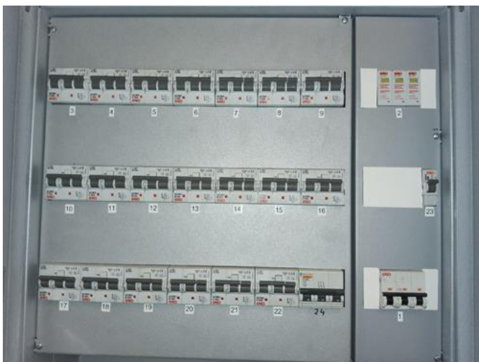
Beskrivelse - [Sikringsskap vaskerom ]
