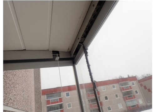
Panel i himling mot vindusfelt er skjevt
