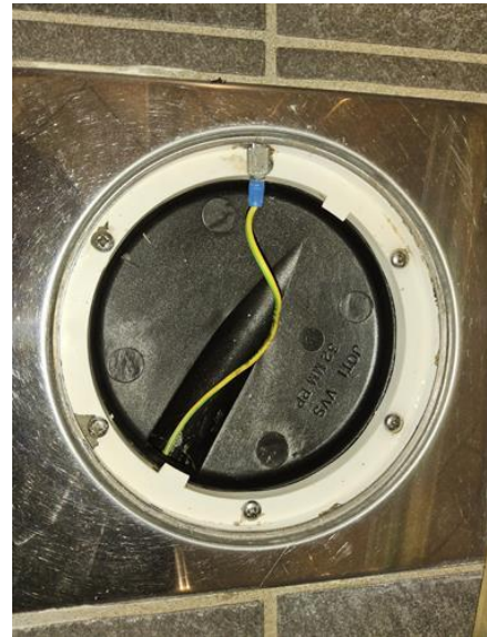
Avløpsrør (ink. sluk) - [Sluk dusjsonen]
