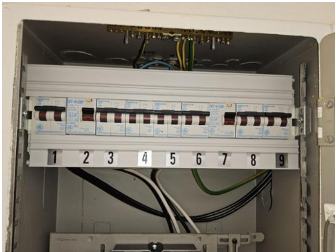
Elektrisk anlegg - [Sikringsskap]
